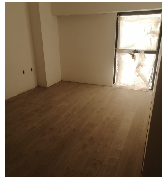
Piso Laminado Nivel 3
