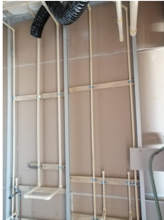
Inst. Hidráulica (Nivel 23)
