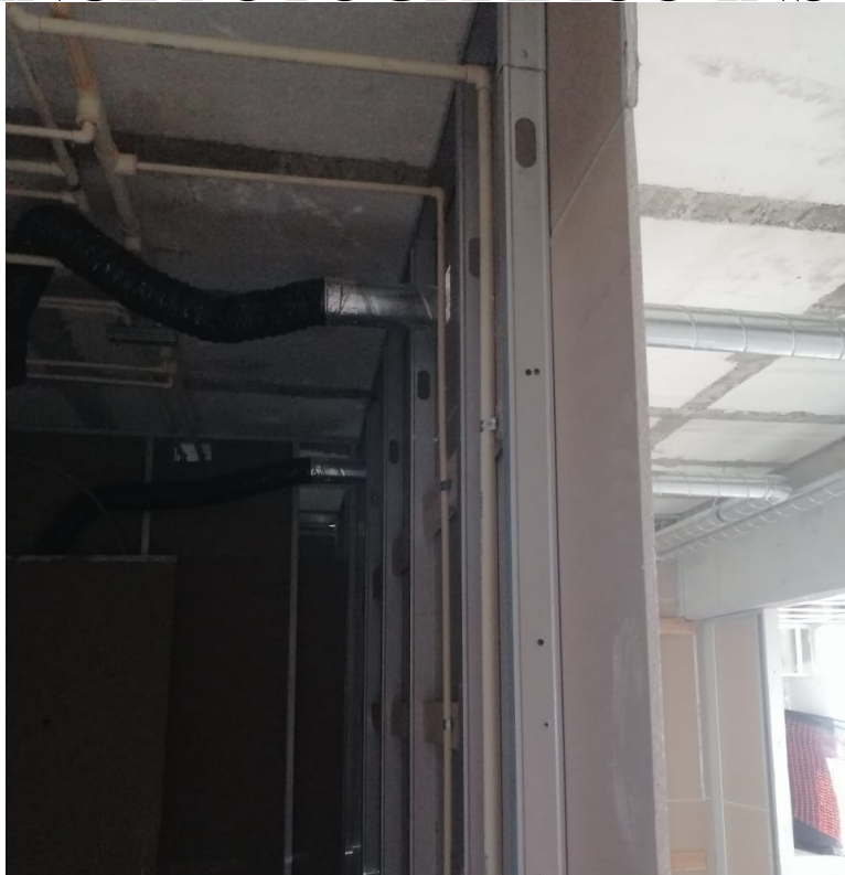
Extracción Aire Caliente (Nivel 23)
