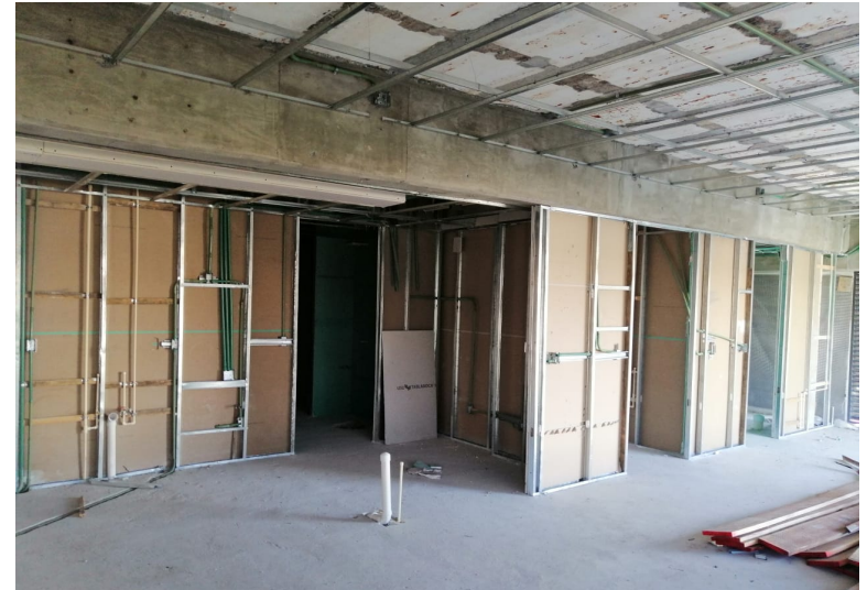
Inst. Hidráulica Nivel 13
