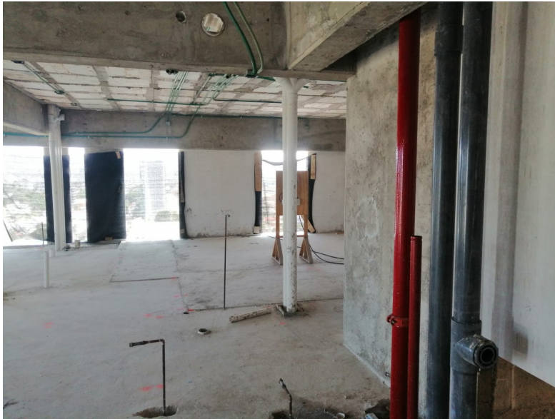
Inst. Hidrante Nivel 13
