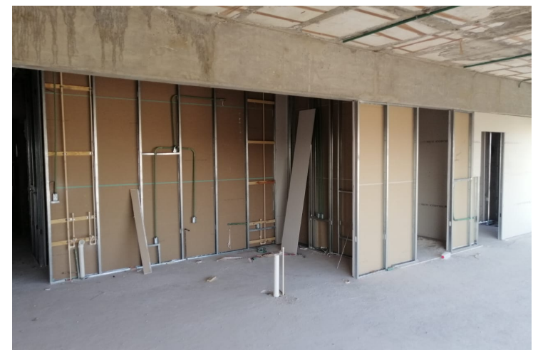
Instalaciones Eléctricas Muro Nivel 13
