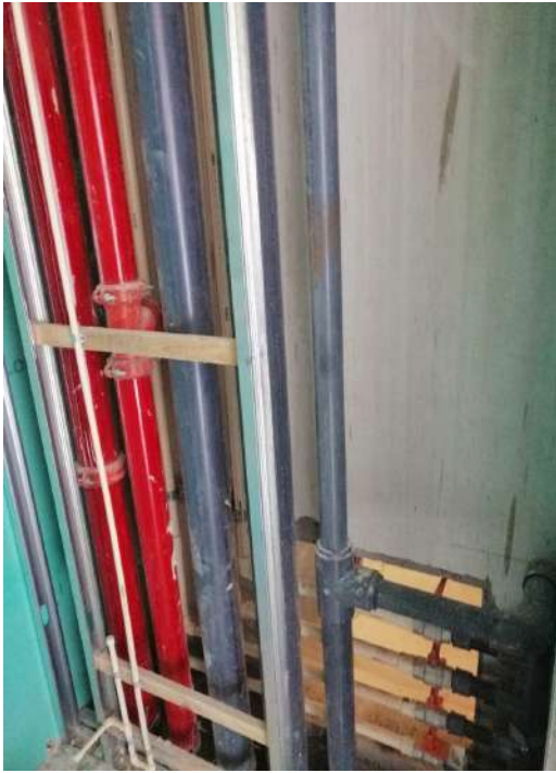
Inst. Hidrante Nivel 17
