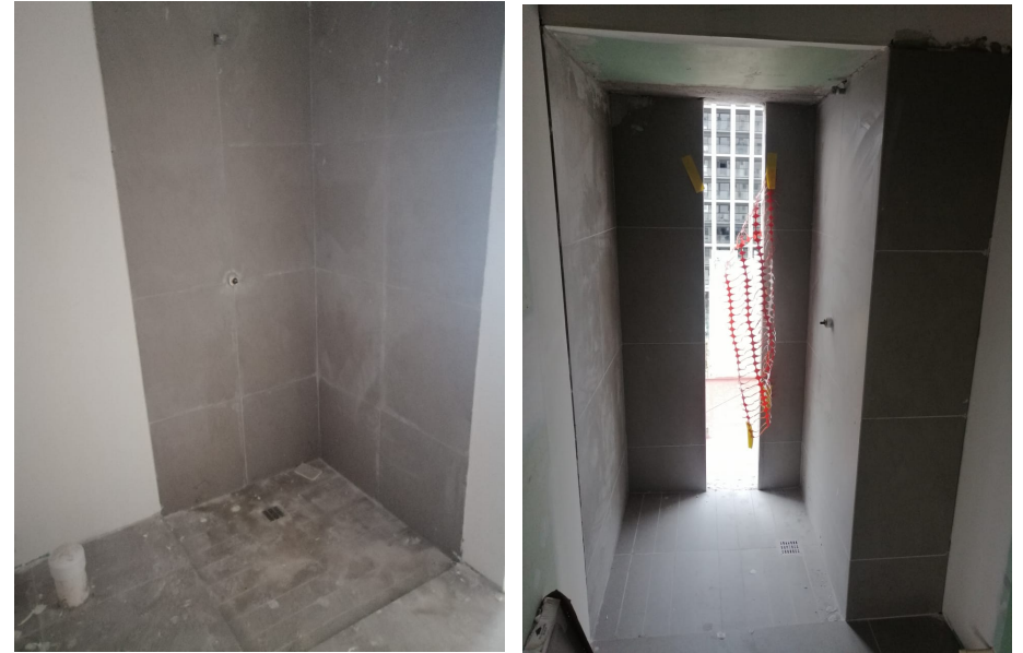
Porcelanato en Regaderas (Nivel 7)
