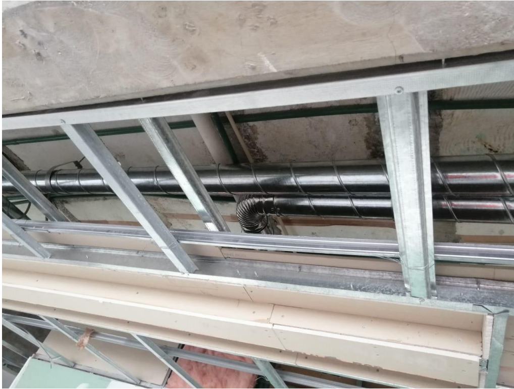
Extracción Aire Caliente (Nivel 15)
