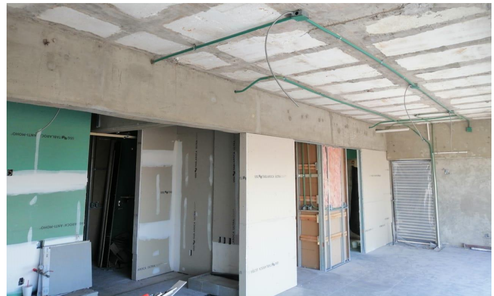
Nivel 15 Cableado (Disparos)
