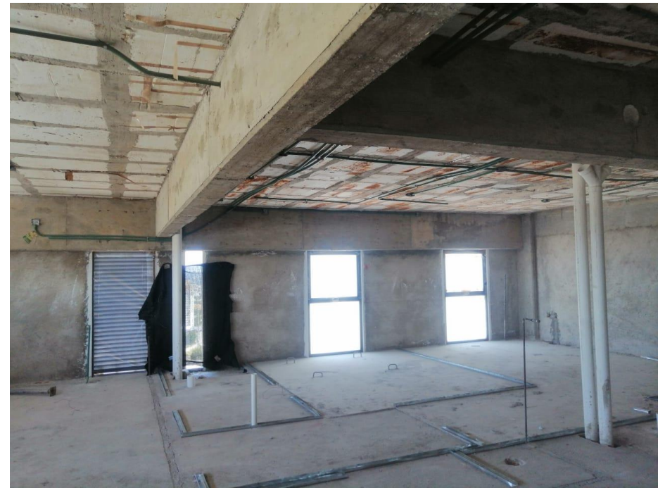
Nivel 22 Inst. Eléctricas en Losa
