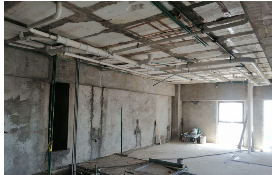
Nivel 21 Instalaciones Sanitarias
