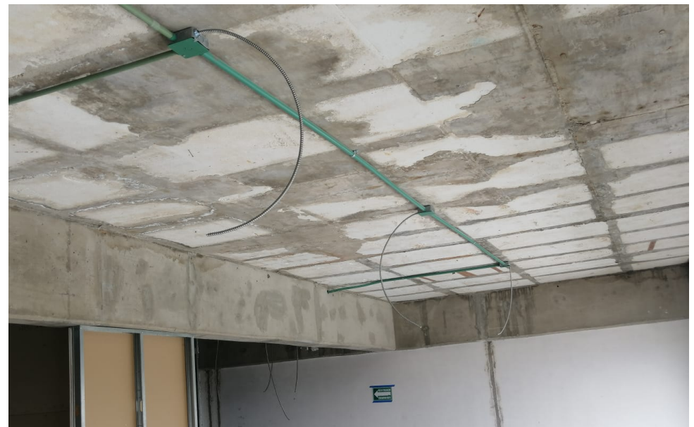
Nivel 15 Cableado (Disparos)
