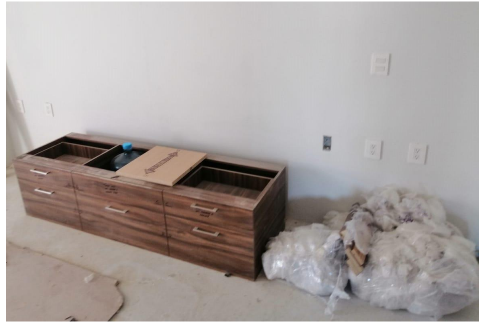
Nivel 03 Inst. Accesorios Eléctricos
